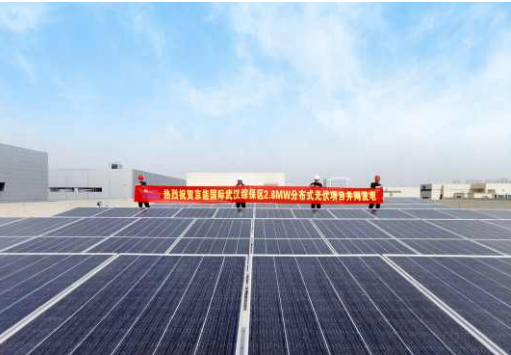
湖北武汉东湖综合保税区产业园10MW (一期2.8MW) 分布式光伏项目
