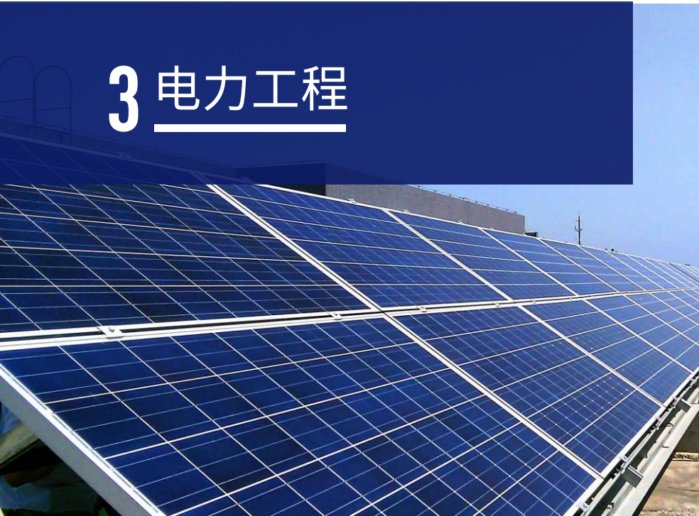
广东省遂溪县乐民镇余村经济联合社分布式光伏发电(三期)项目,装机容量113.94kw 安装面积约1000平方米
